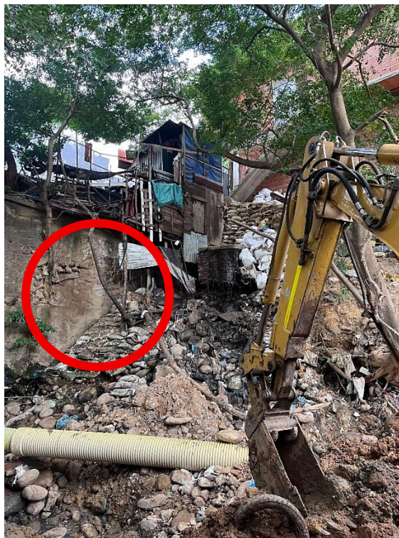
Imagen 1 “caja en mal estado vertiendo al caño”
