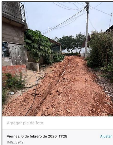
Fotografía 3 Se observan excavaciones sobre el tramo descrito por AQUALIA sin previa aprobación.
