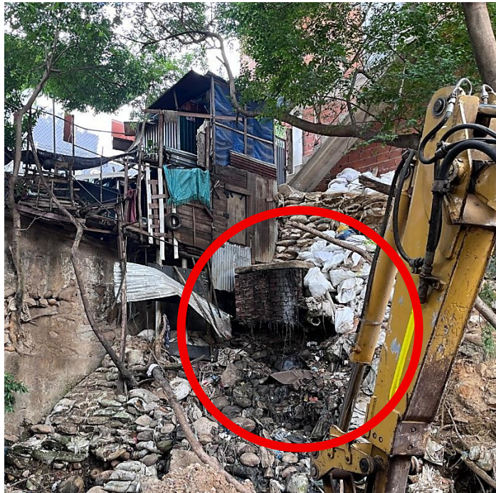
Imagen 2 “caja en mal estado vertiendo al caño”
