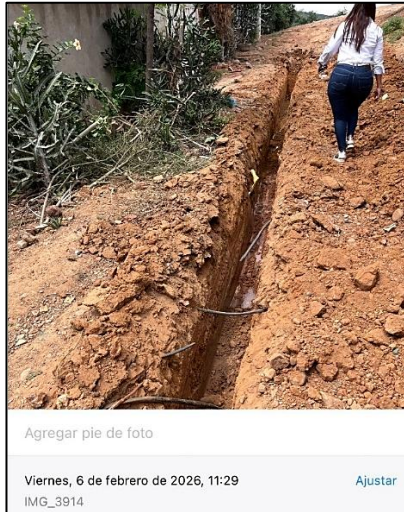
Fotografía 5 Se observan excavaciones sobre el tramo descrito por AQUALIA sin previa aprobación.
