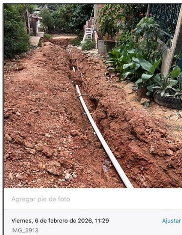
Fotografía 4 Se observan excavaciones sobre el tramo descrito por AQUALIA sin previa aprobación.
