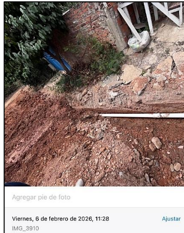
Fotografía 2 Se observan excavaciones sobre el tramo descrito por AQUALIA sin previa aprobación.
