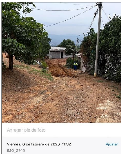
Fotografía 6 Se observan excavaciones sobre el tramo descrito por AQUALIA sin previa aprobación.
